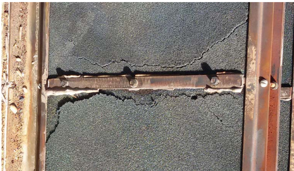
Рис. 1. Разрушенная каталитическая пластина после трех дней эксплуатации
